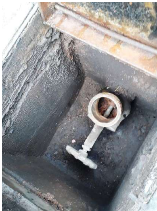
Figura 21 - Hidrante de passeio existente no passeio público.
