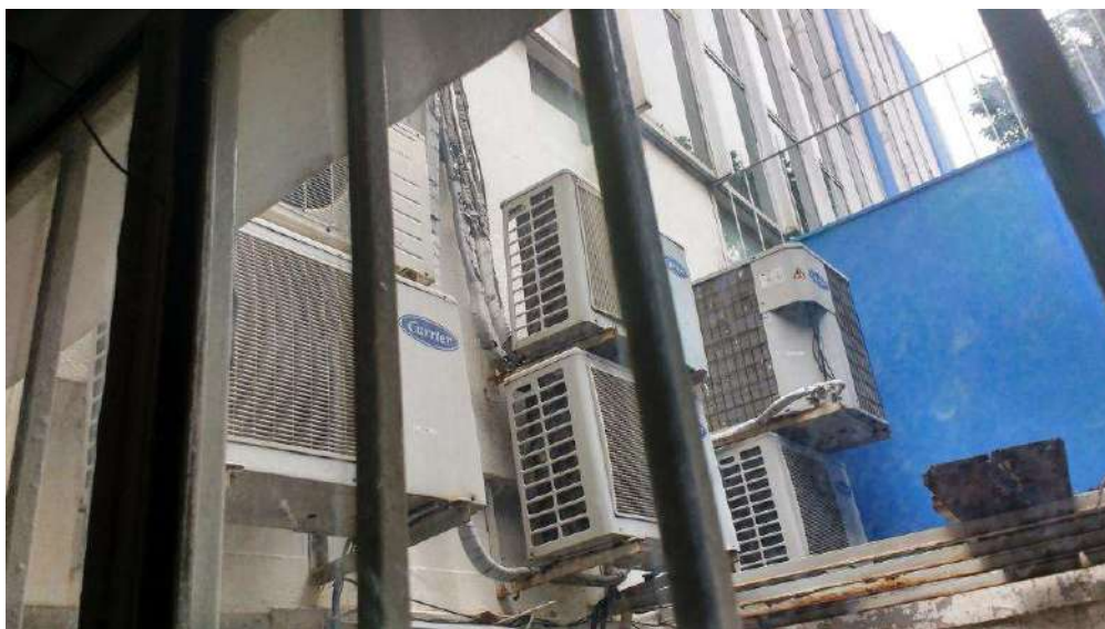
Figura 9 - Aparelhos de Ar-Condicionado a serem retirados.
