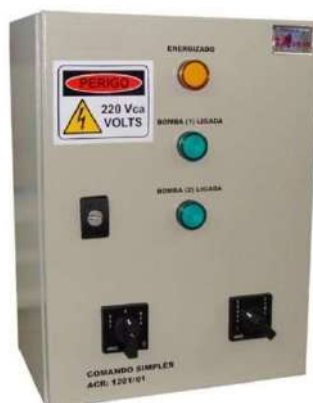
Figura 24 - Imagem Referência – Painel de sinalização das bombas.
