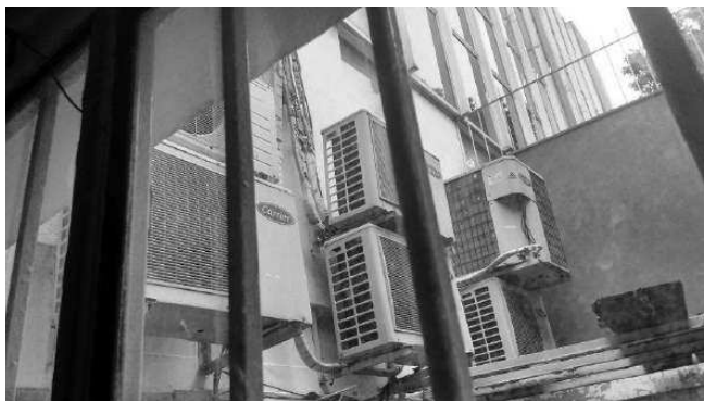
Figura 9 - Aparelhos de Ar-Condicionado a serem retirados.
