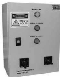
Figura 24 - Imagem Referência – Painel de sinalização das bombas.
