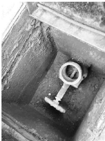
Figura 21 - Hidrante de passeio existente no passeio público.
